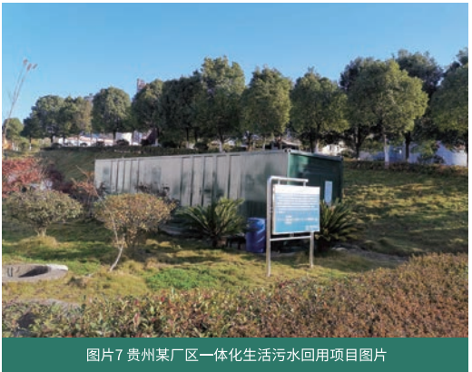
贵州某厂区一体化生活污水回用项目
