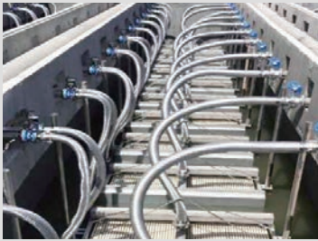
山西某市政生活污水项目(65000m3/d)
