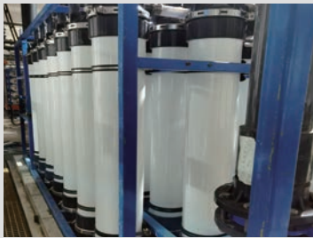
徐州某热电厂净水项目 (800m3/d)
