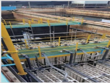
浙江某印染企业双膜法废水处理项目 (2000m3/d)
