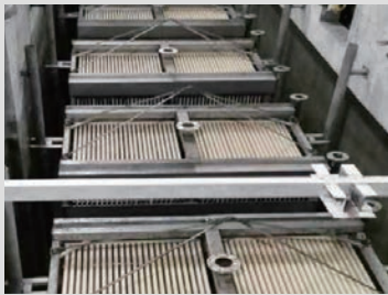
新疆某建设兵团市政生活污水项目(6000m3/d)
