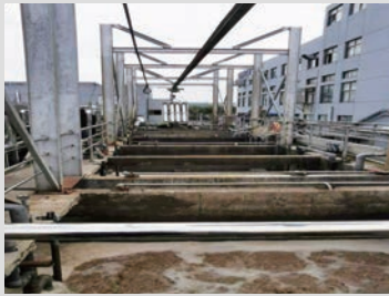
南通某含胶废水中水回用项目 (3500m3/d)
