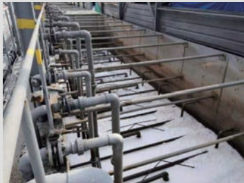
浙江洪合某印染废水处理项目 (2500m3/d)
