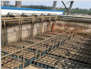
山东某家纺企业印染水处理项目 (3000m3/d)
