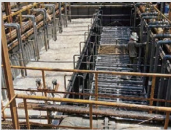
浙江濮院某印染废水项目 (1800m3/d)
