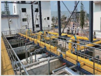
四川遂宁某工业污水处理项目 (2400m3/d)
